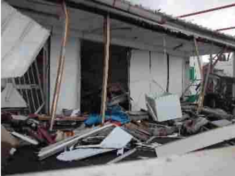
Tipico danneggiamento prodotto nelle abitazioni di Punta Lena (Stronboli) dal maremoto del 30 Dicembre 2002. La violenza dell'acqua ha trasportato ed ammassato mobili e suppellettili fuori dalle case. (Foto scattata durante la campagna di misure a Stronboli e Isole Eolie nel Gennaio 2003 da ricercatori dell'Istituto Nazionale di Geofisica e Vulcanologia- Roma)
